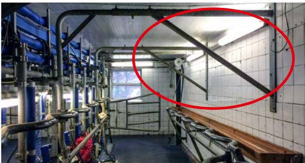
Schon bei der Planung kann berücksichtigt werden, dass Querverstrebungen, die die Hörnerfreiheit behindern, vermieden werden sollten. Dies hätte hier möglicherweise konstruktiv anders gelöst werden können.
